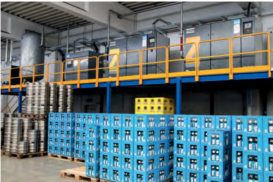
Die Druckluftstation steht in der Lagerhalle. Mit der warmen Abluft wird die Halle erwärmt, so dass die Etiketten auf den frisch abgefüllten Flaschen schnell trocknen. Früher musste hier geheizt werden.
