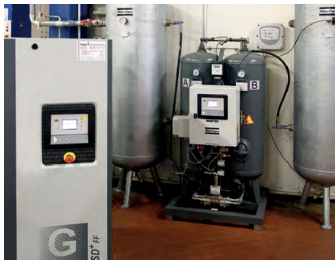
Diese „Prototypen“-Station mit einem kleinen GA-Kompressor und einem dazu passenden Stickstoffgenerator des Typs NGP 30 war die erste Anlage zur eigenen Stickstoffherzeugung. Sie steht in unmittelbarer Nähe der Fleischverarbeitung bei Vitakraft.
