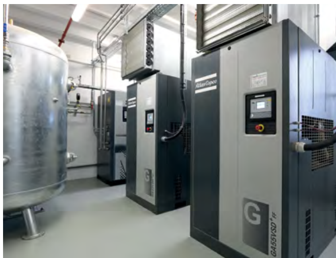
Die neue Druckluft- und Stickstoffstation bei Vitakraft umfasst fünf drehzahlgeregelte GA-VSD-Kompressoren (zwei im Bild) sowie einen Stickstoffgenerator des Typs NGP 100 + (hinten im Bild).
